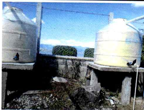
Foto 7: Rotoplas instalados para abastecimiento de agua y captación de agua pluvial.
